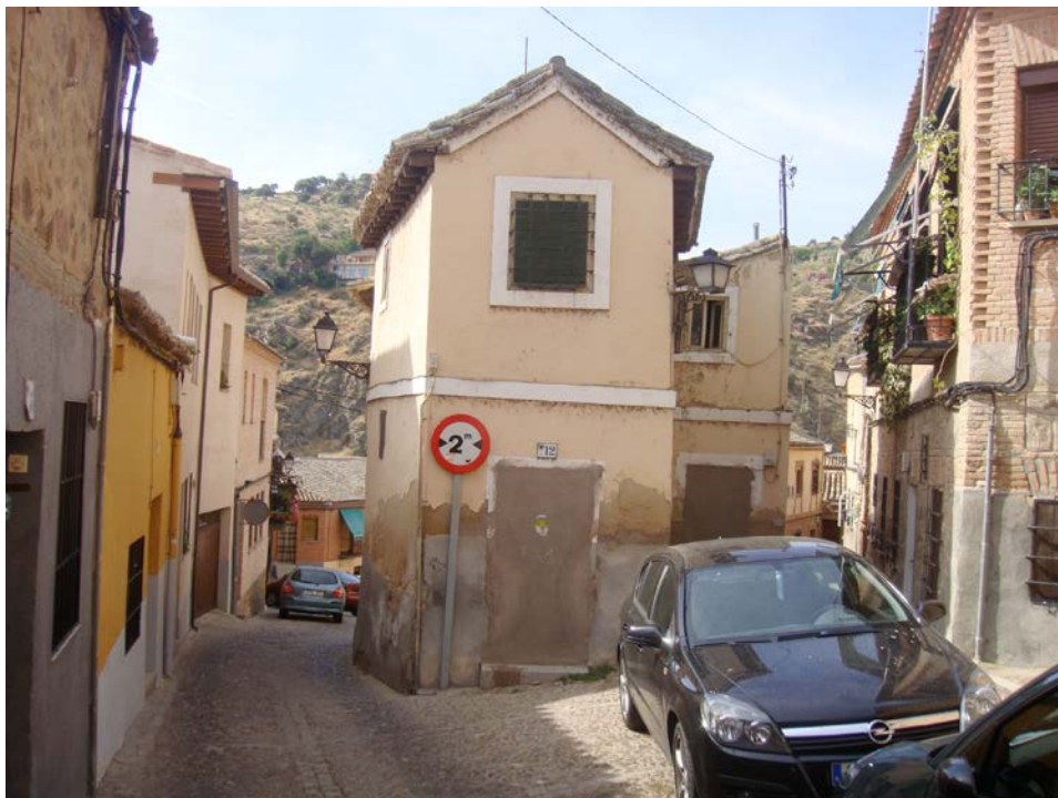
Estado actual de la Casa de la Galera , tapiada y mostrando los primeros daños en el tejado.
