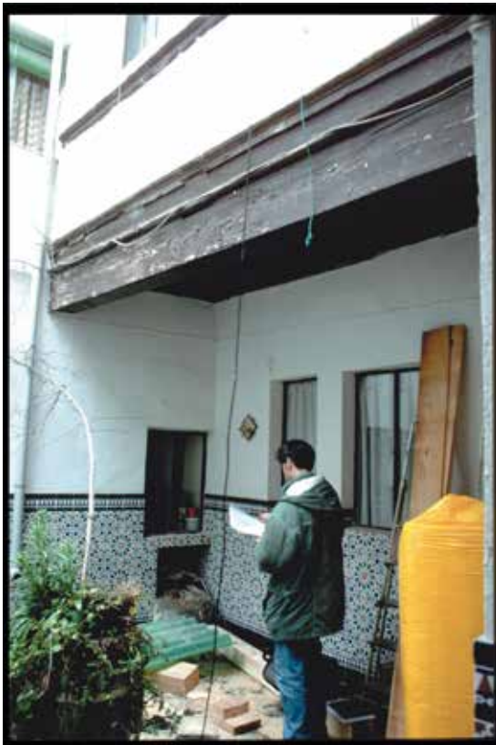
Bajada del Pozo Amargo, n° 10: el pozo se sitúa en el ángulo noroeste del patio de la casa D-4.
