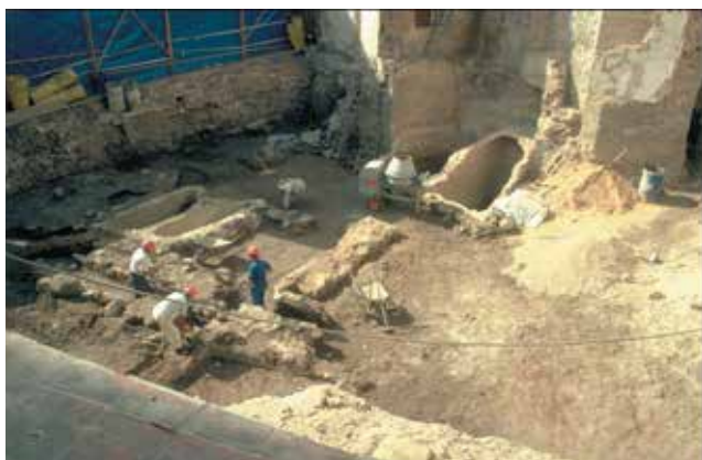
Calle de la Ciudad: Excavaciones arqueológicas en la casa de Pedro Carrillo.
