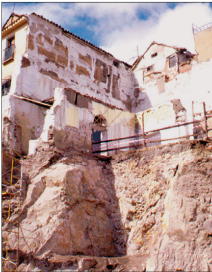
Fig. 15. Callejón de San Pedro n.º 18. El palacio principal del siglo XII, antes de su demolición para poner un ascensor.
